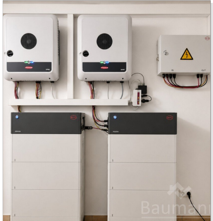
Wechselrichter inklusive Stromspeicher Einfamilienhaus Unkel Scheuren
