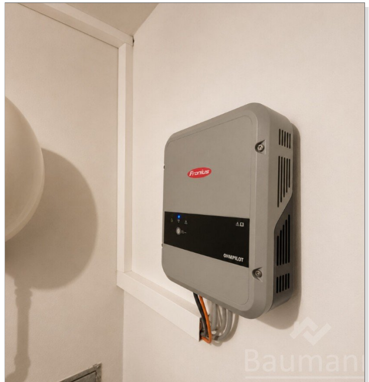
Verbrauchsregler für überschüssigen PV-Strom Einfamilienhaus Unkel Scheuren
