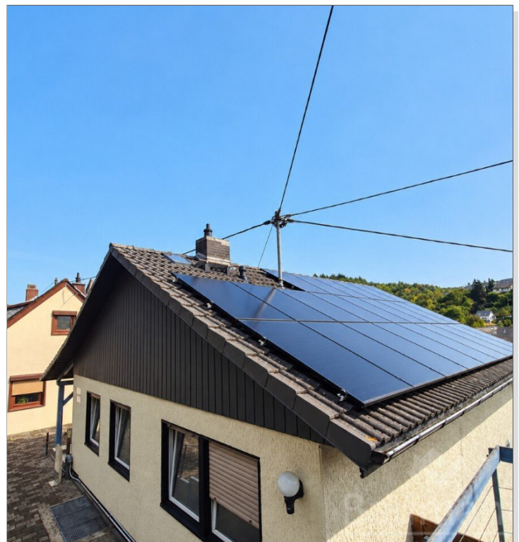
PV-Anlage mit Südwest-Ausrichtung - Einfamilienhaus in Bad Hönningen (*)
